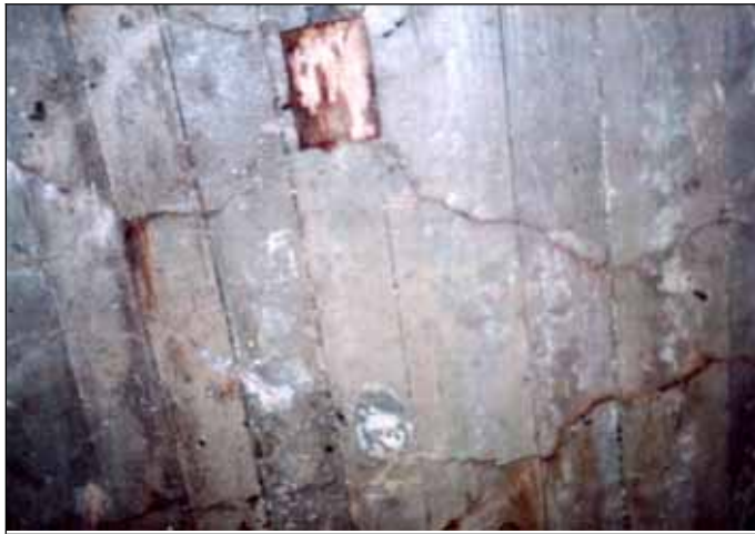
Dokument 9: Einer der Befestigungsblöcke für Lampen in der Decke von Leichenkeller 1 im Krematorium II von Birkenau. Oktober 1991. © Carlo Mattogno.
