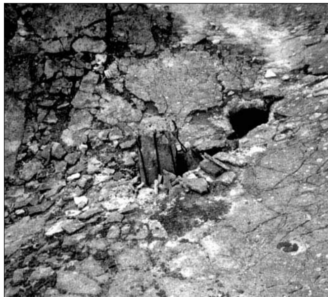
Dokument 8: Leichenkeller 1 im Krematorium II von Birkenau. Aus der Stahlbetondecke ragender Stützpfeiler und die von diesem verursachten Risse. August 2000. © Carlo Mattogno.
